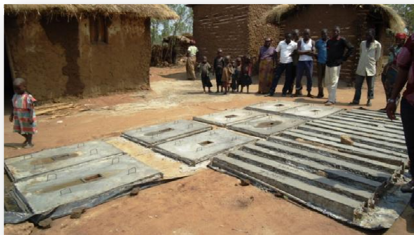
Les bénéficiaires de la colline de Kagwema près des dalles et des poutres qui, une fois séchées, seront utilisées pour construire leur latrine.
