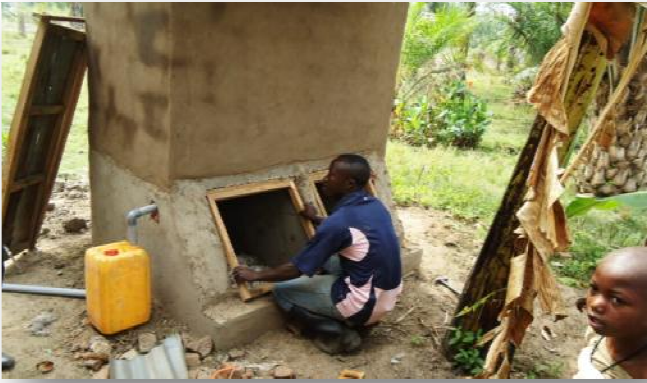
Le maçon de PAD en train de réaliser une fosse dans une latrine Ecosan à Kizina A.
